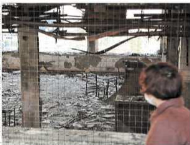
津波と火災の痕跡を残す「門脇小」11月8日、石巻市
