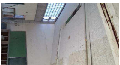
2階の天井に波の跡
